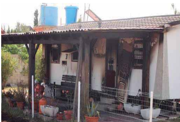
Fig. Vivienda que se quemó el año pasado en julio en El Palmar (Vejer). Toda la construcción carece de regulación.
